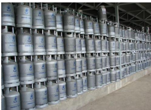
ถังบรรจุก๊าซ (Cylinder)
